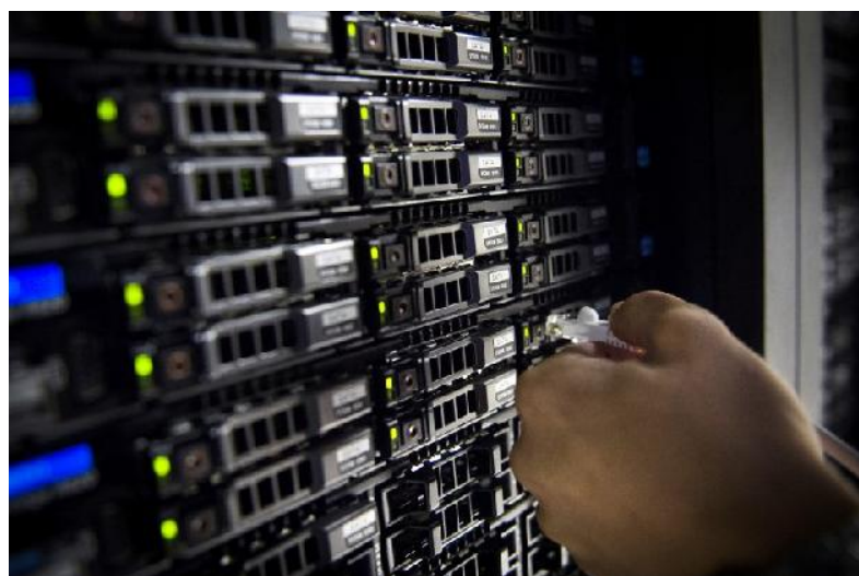
Dans un data center
